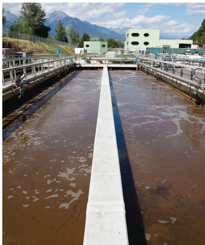
Des stations d'épuration pour la qualité de l'eau. CHRISTIAN LAUBACHER
